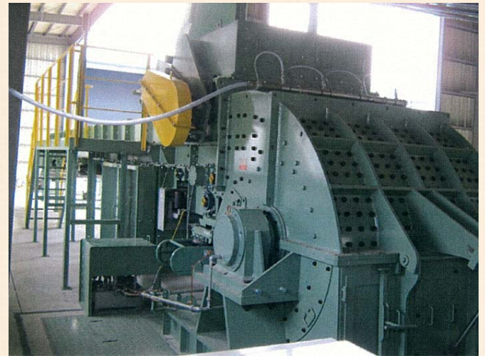
木質バイオマス燃料製造施設
