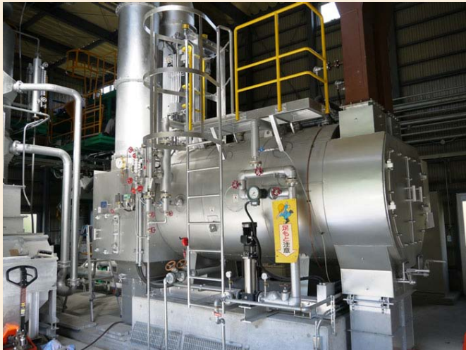
排熱ボイラー施設
